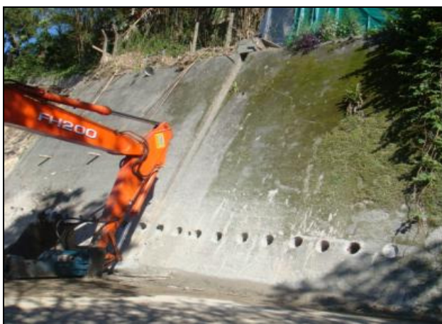
Figura 1. Trecho do talude destinado a instalação dos grampos convencionais e não convencionais.
