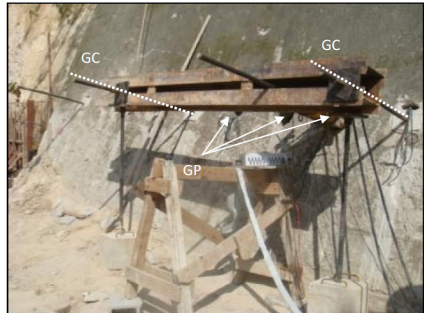
Figura 7. Viga de reação utilizada nos ensaios de empurramento dos grampos com fibras.
